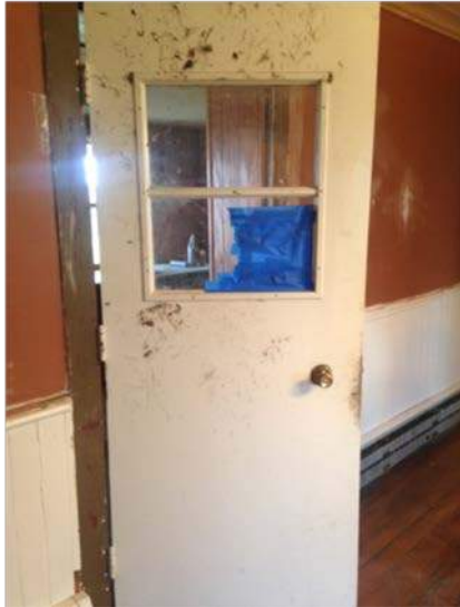
Door 3-1, Broken Light
